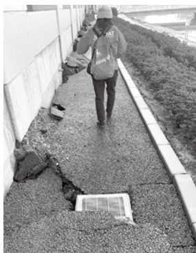
亀裂や陥没、隆起が激しい穴水町保健センター周囲の歩道
